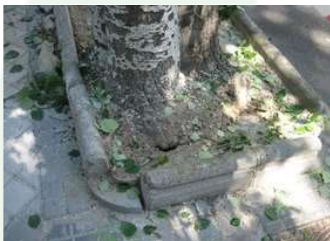
Detalle de alcorque que ocasiona daños en el entorno del ejemplar
