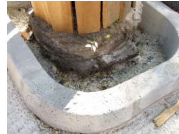
Detalle de obra de nueva pavimentación en el viario. Definición de nuevo alcorque
