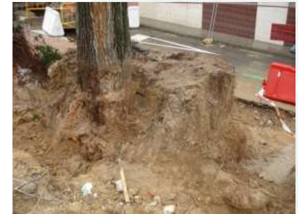
Detalle de afección a la base del árbol por obra en entorno viario
